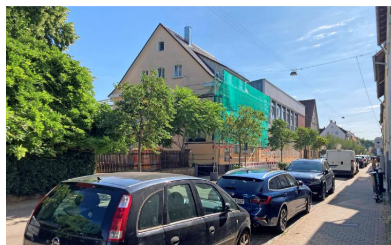
Beim Umbau des ehemaligen Nikolaigemeindehauses an der Dammstraße 55 lag der Architekt beim Brandschutz völlig daneben.
